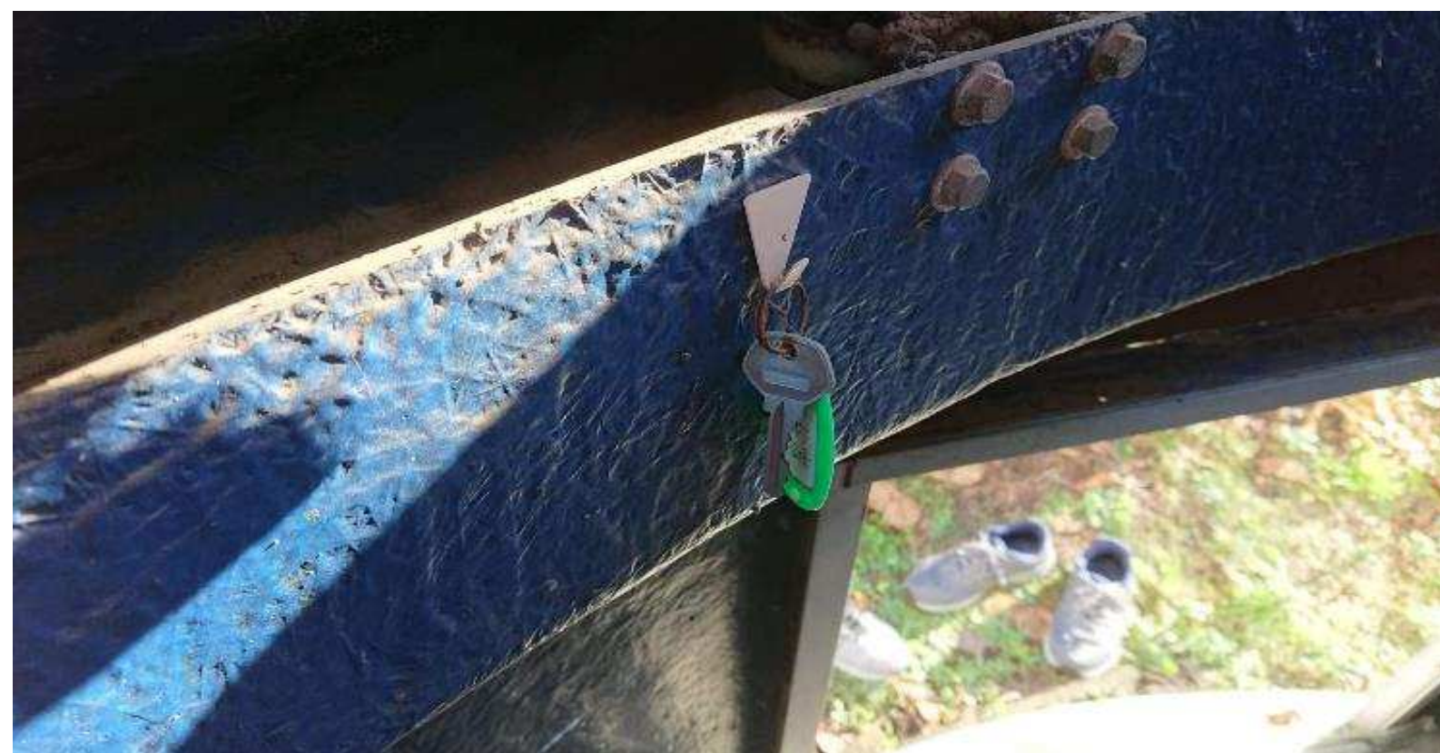
銚(土,砂等)が溜まってドームの屋根の回転に支障あり
